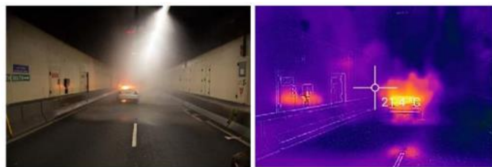
Figura 5: Activación del Deluge System la temperatura se reduce a 21,4°C
