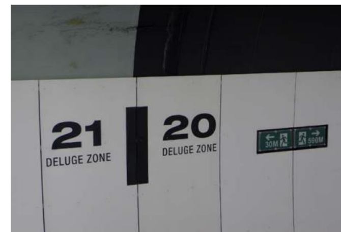
Figura 16: Señalización de delimitación de zonas de rociadores
